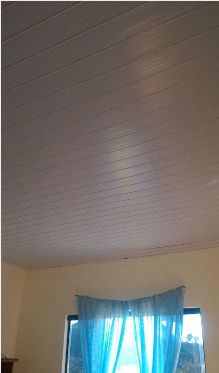
Foto 04: Condições gerais do forro.
