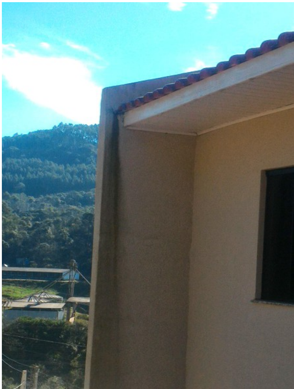
Foto 02: Problema ocasionado pela falta de calhas, já existente.
