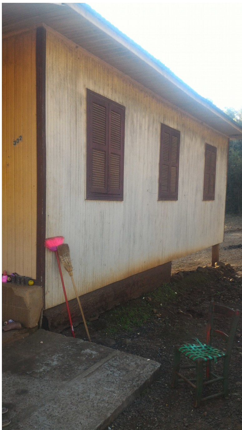
Foto 01 Condições existentes na residência.
