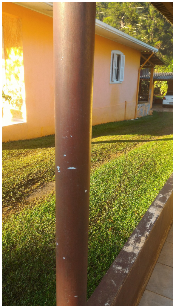
Foto 02: Condições da pintura no momento da locação.
