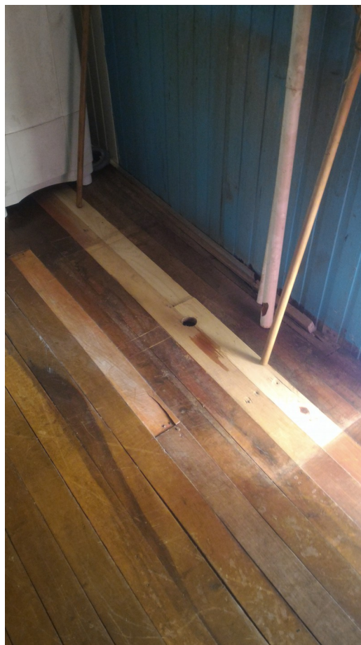
Foto 04: Piso de madeira existente, com furos para passagem de encanamentos.
