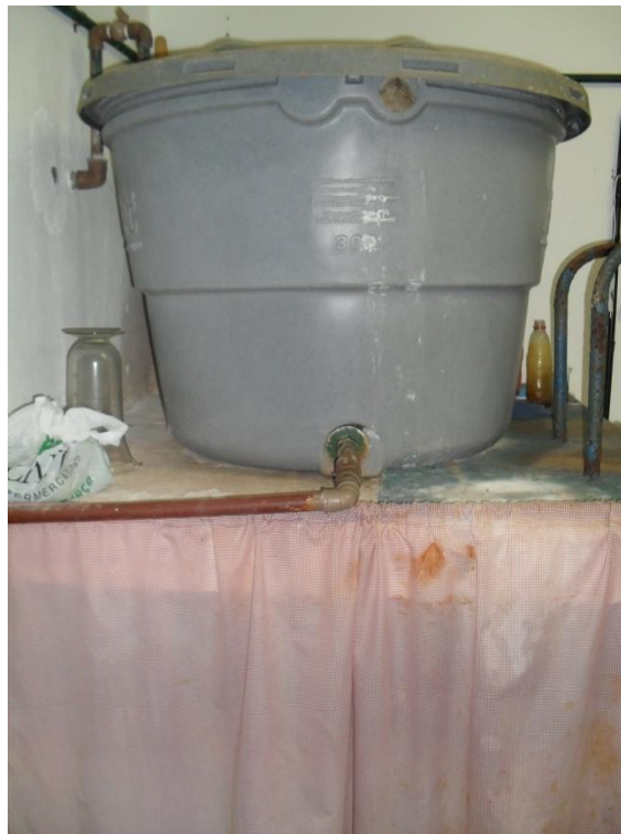
Foto 8 – Tanque de Preparo de Soluções
