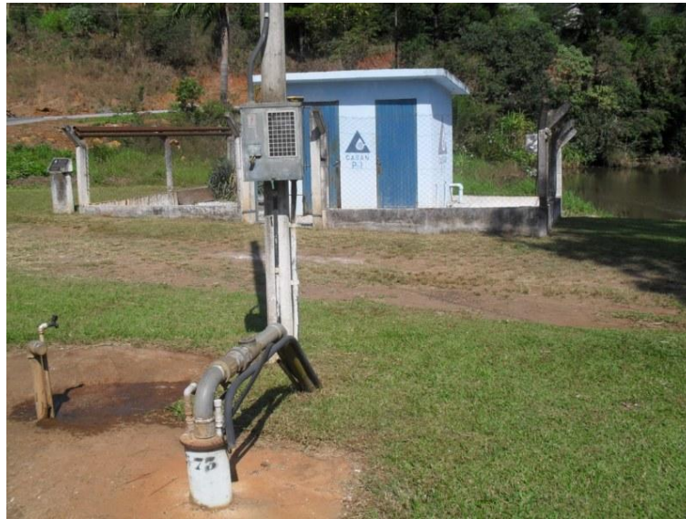
Foto 6 – Manancial Subterrâneo – Poço 01
