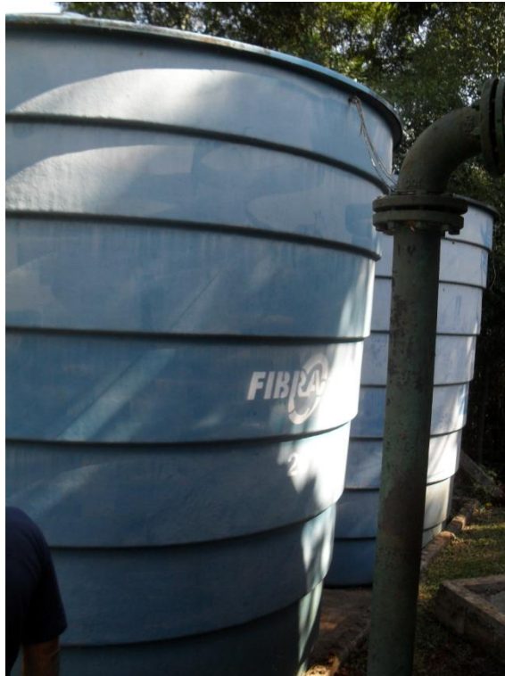
Foto 16 – Conjunto de Reservação 01
