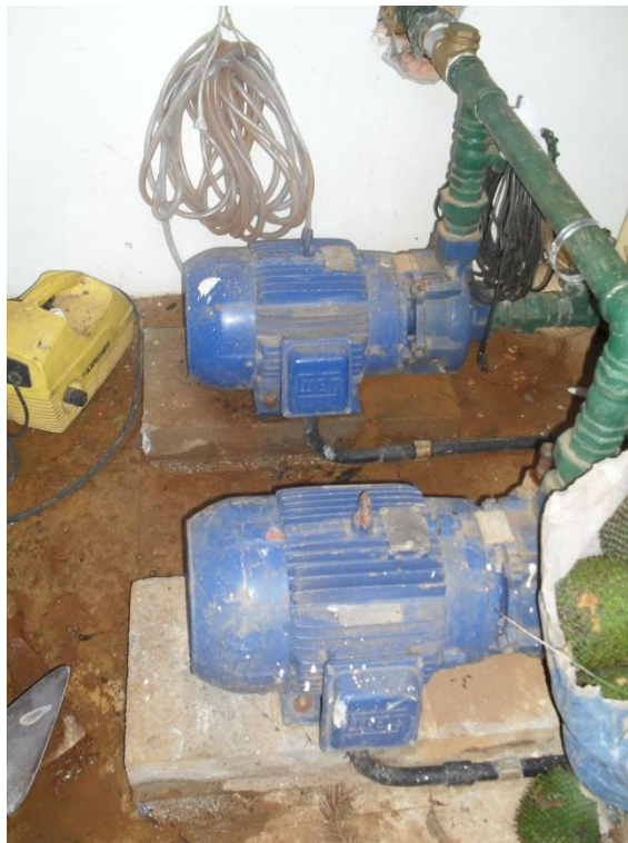
Foto 14 – Conjunto moto-bomba ERAT 02
