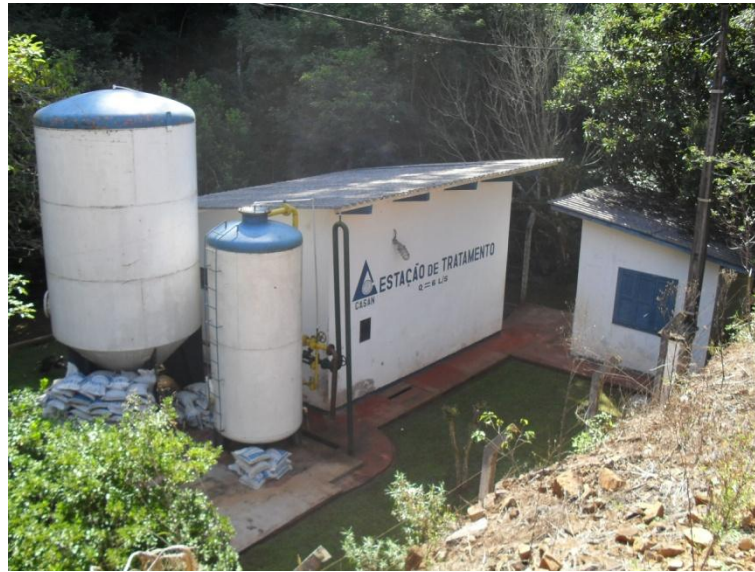
Foto 7 – ETA Compacta Metálica Fechada
