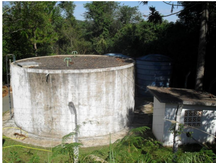
Foto 15 – Conjunto de Reservação 01
