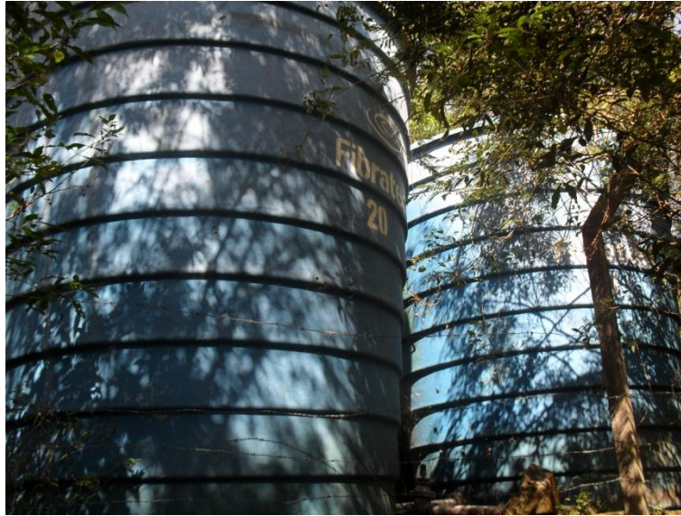
Foto 18 – Reservatórios Parque São Cristóvão
